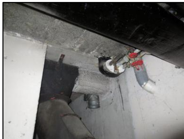
Photo N° 940 AMIANTE CIMENT -- LOCAL VO -1 Gaines & coffres horizontaux Coude de ventilation haute (Fibres-ciment)
